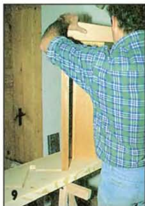
9 Убедившись, что всё в порядке, лестницу снимают и разбирают. Теперь нужно установить остальные ступени.
